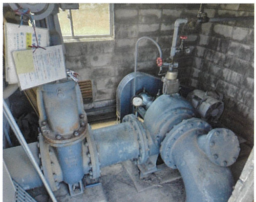
狸塚地区揚水機場
