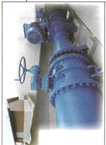
待矢場三栗谷発電所
