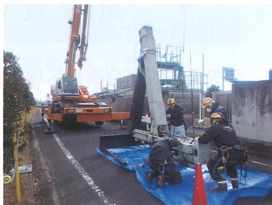
新田堀幹線地区 除塵機整備状況
